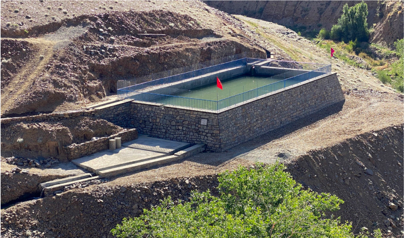
Afghanistankomiteen har bygd dette vannreservoaret i samarbeid med ingeniører og lokalbefolkningen. I tillegg til å sørge for vann til vanning og klesvask er reservoaret et sosialt møtested.
