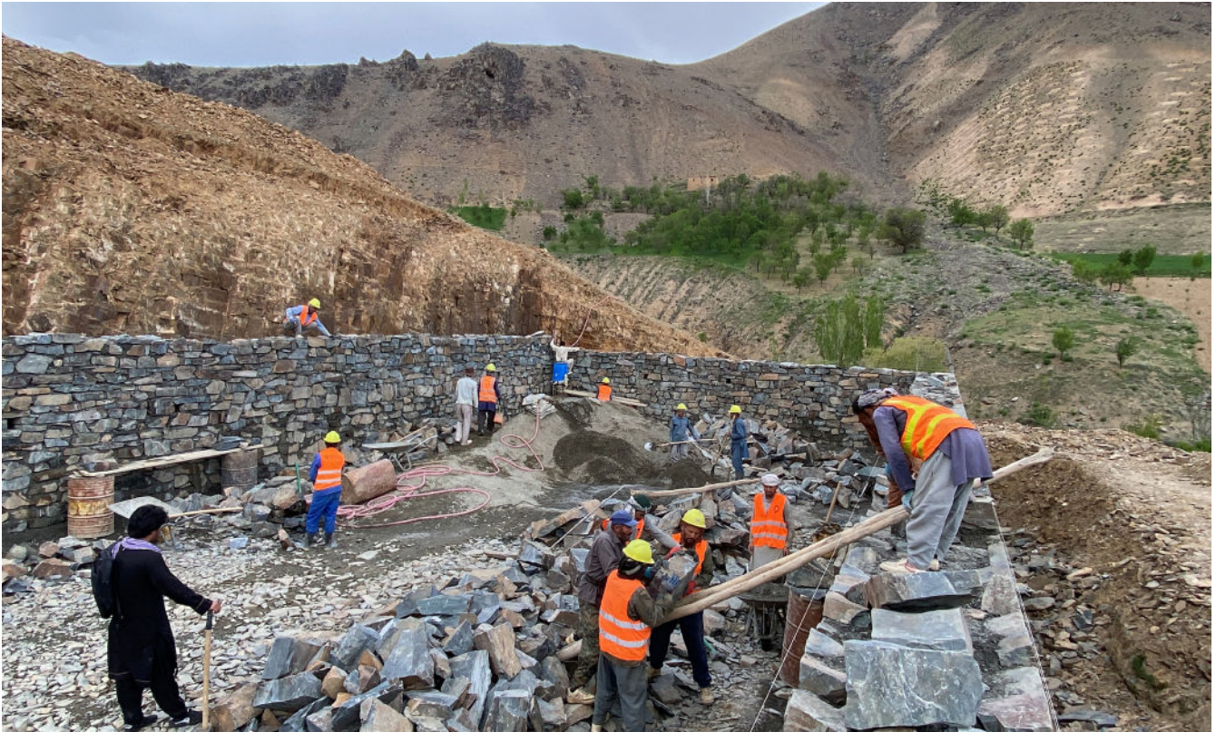
Unge og arbeidsledige i Waragha fikk både jobb og bedre kunnskaper og ferdigheter i murerfaget, alt dette i et sikkert arbeidsmiljø.
